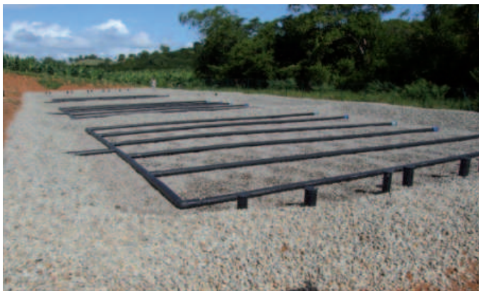
Le circuit d'alimentation du deuxième filtre
