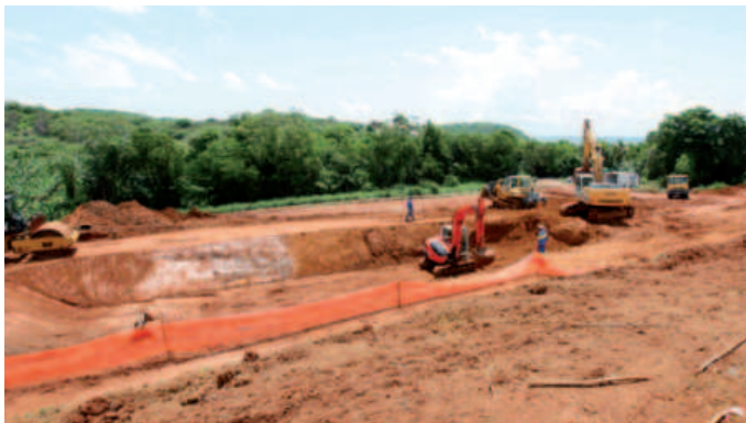
Le chantier de construction de la STEP (station d'épuration) de Mansarde Rancée
