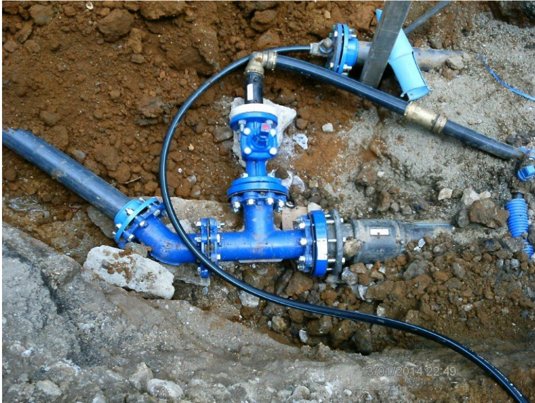
Raccordement de la caanlisation DN 200 de Rivière Pomme à la distribution du réservoir Vert Pré3
