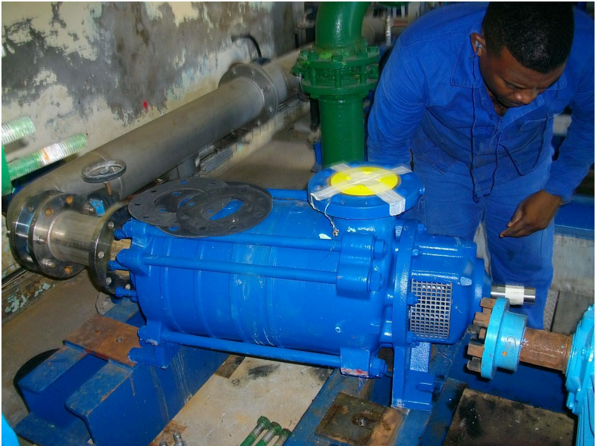
Montage de la seconde pompe de refoulement vers Dominante de l'UPEP du Lorrain
