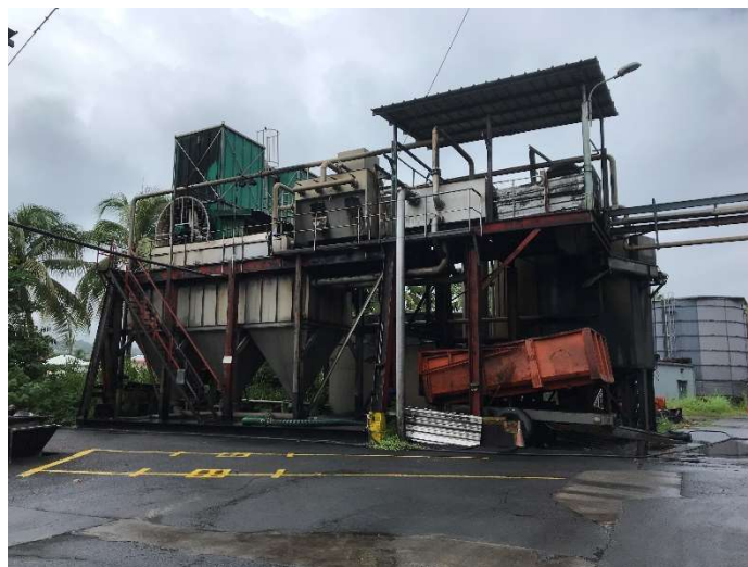
FIGURE 20: SITE DE TRAITEMENT DES VINASSES
