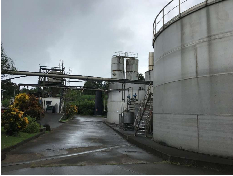
FIGURE 21 : CUVES DE METHANISATION DE SAINT JAMES
