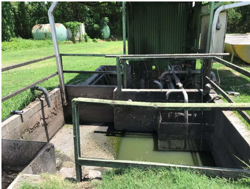
FIGURE 25 : DEGRILLEUR DE LA DISTILLERIE DU SIMON
