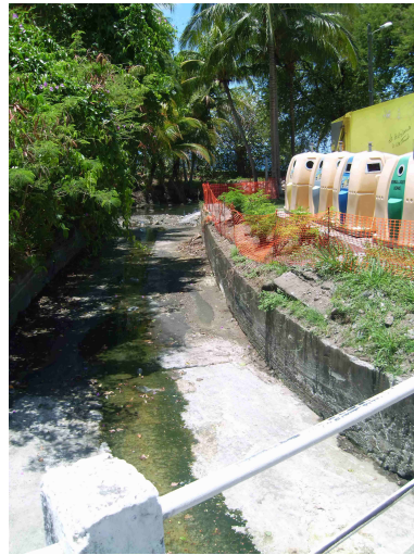
b. Lit et berges bétonnées de la rivière de Fond Boucher – Case-pilote.
