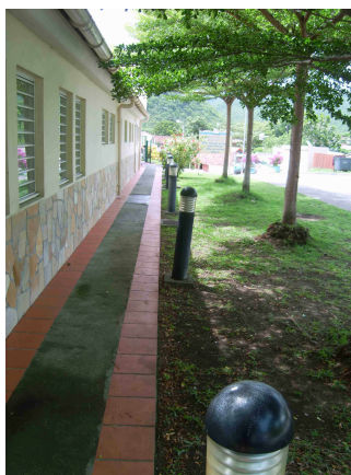
Figure 7: Luminaires de faible hauteur - Bourg des Anses d'Arlet.
