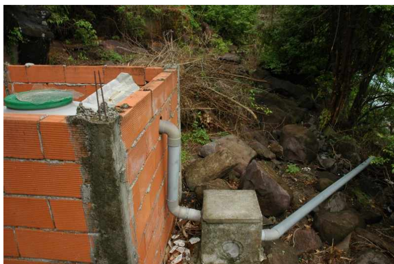
Figure 54: Système d'assainissement non collectif à contrôler - Anse Dufour aux Anses d'Arlet.
