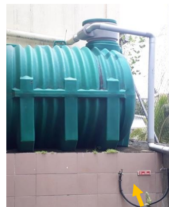
Figure 100 : l'accès au préfiltre (ici à 2,5m du sol) et son démontage pour laver l'intérieur de la cuve peuvent être des démarches complexes qui requièrent l'intervention de quelqu'un de compétent.
