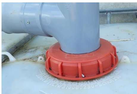
Figure 52 : exemple de bouchon modifié pour un meilleur hermétisme de la cuve. Ici la jointure
