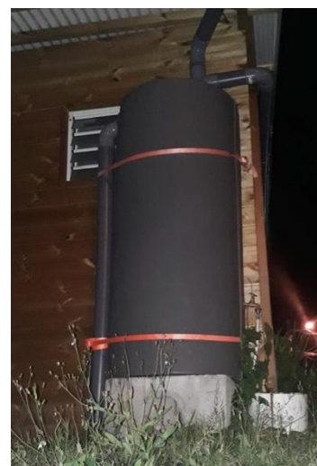
Figure 47 : Exemple de cuve extérieure
