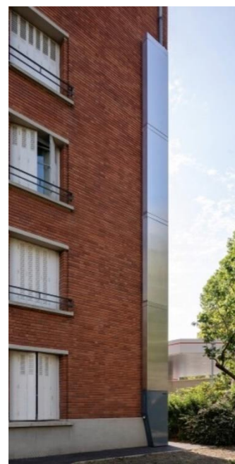
Figure 108 : Réservoir Reënstock : Ces citernes-tampons d'un nouveau genre, l'eau de pluie ainsi collectée ne rejoint plus directement les égouts. Elle est récupérée pour une valorisation in situ permettant d'arroser sans consommation et frais les espaces verts et l'ensemble d'habitation et d'un jardin partagé géré par une association de quartier.
