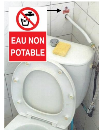
Figure 76 : le pictogramme « eau non potable » doit impérativement être apposé sur tous les points de distribution
