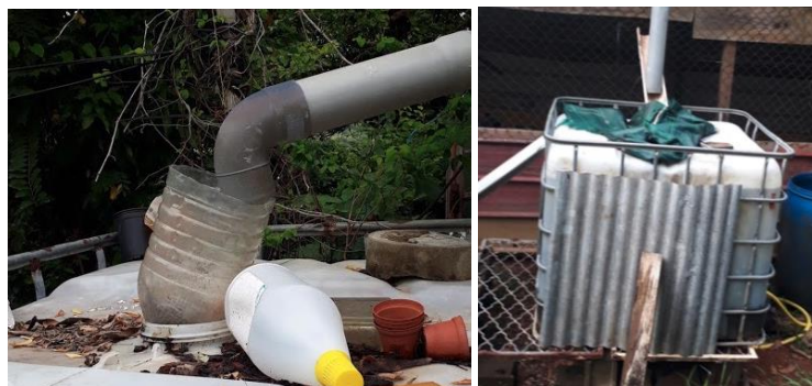
Figure 50 : exemples de raccordement et filtration inefficaces
