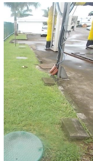
Figure 93 : cuve de recyclage enterrée
