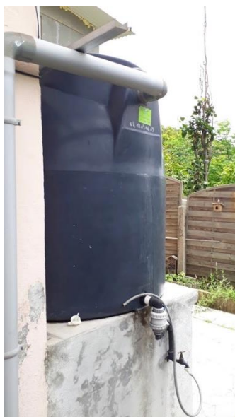
Figure 58 : Sur cette installation, la cuve est posée sur un piédestal afin d'assurer son fonctionnement en gravitaire (bourg du Robert)
