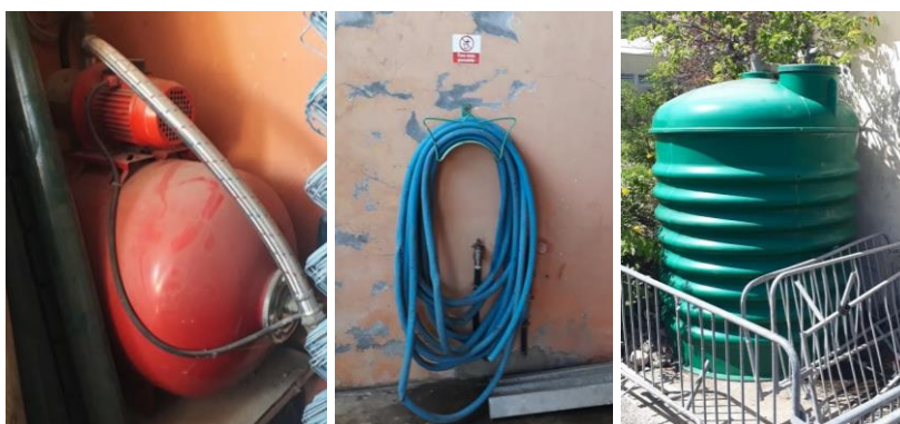
Figure 86 : Photographies du SREP installé
