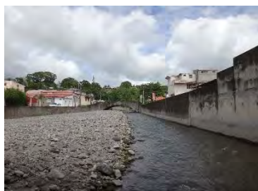
Vue vers l'amont de la station
