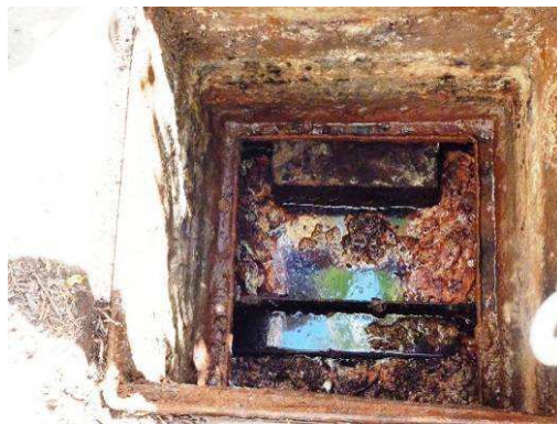
Photo 1 : Exemple de boîte à graisse d'un restaurateur
