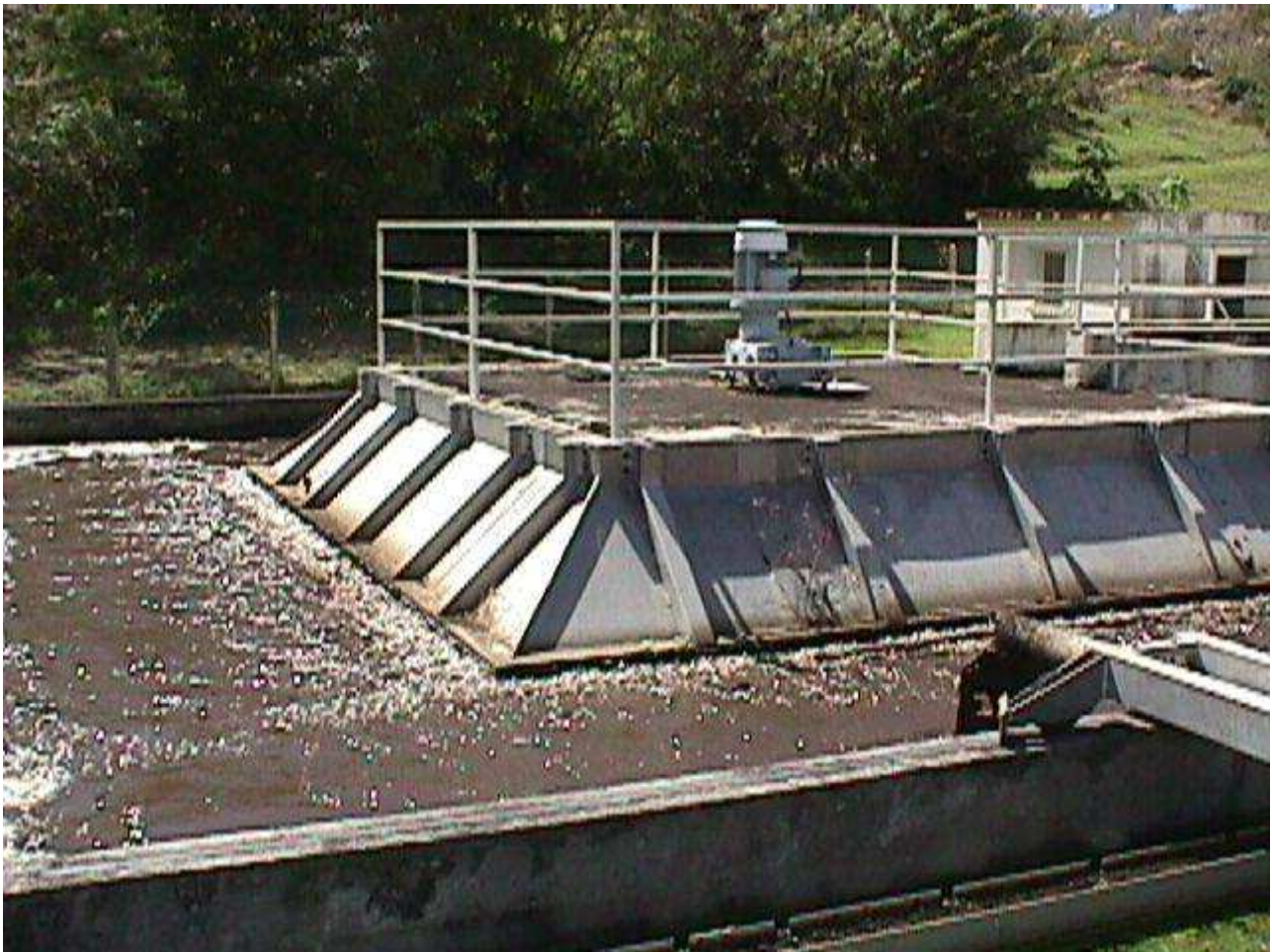
Station de traitement d'eaux usées de DIZAC
