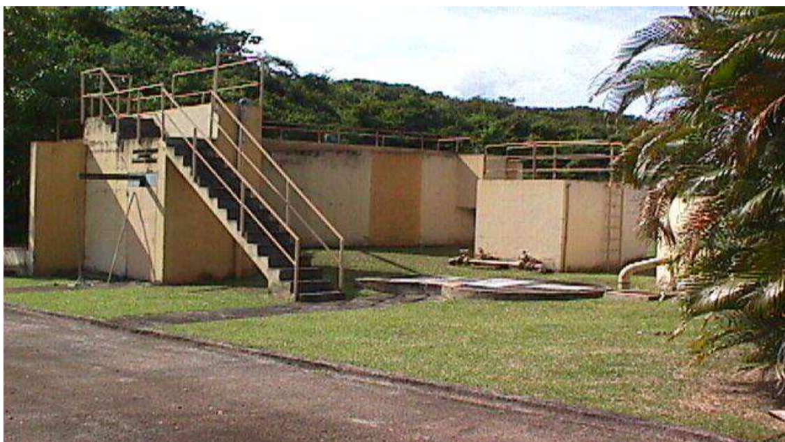
Station de traitement d'eaux usées du Bac
