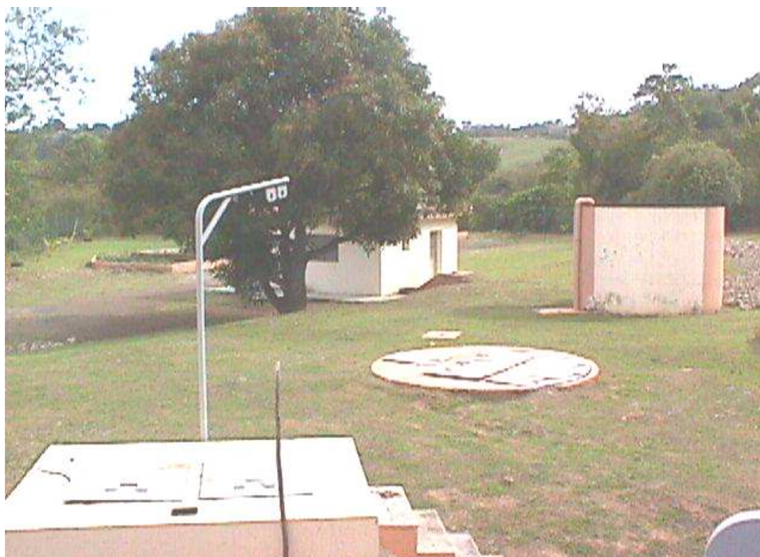
Station de traitement d'eaux usées de Tartane
