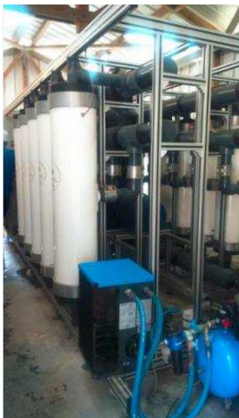
Les modules d'ultra-filtration d'Urion avant leur renouvellement
