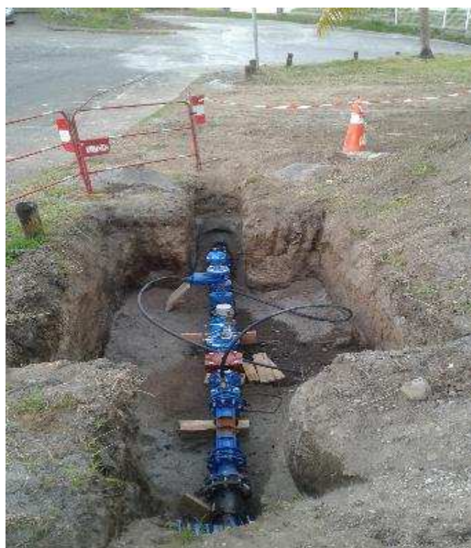
Installation stabilisateur de pression Morne savane (carbet)
