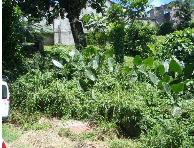
Fosse septique de Bout Bois, le Carbet.
