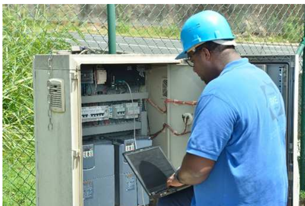
Paramétrage d'un SOFREL sur un poste de refoulement
