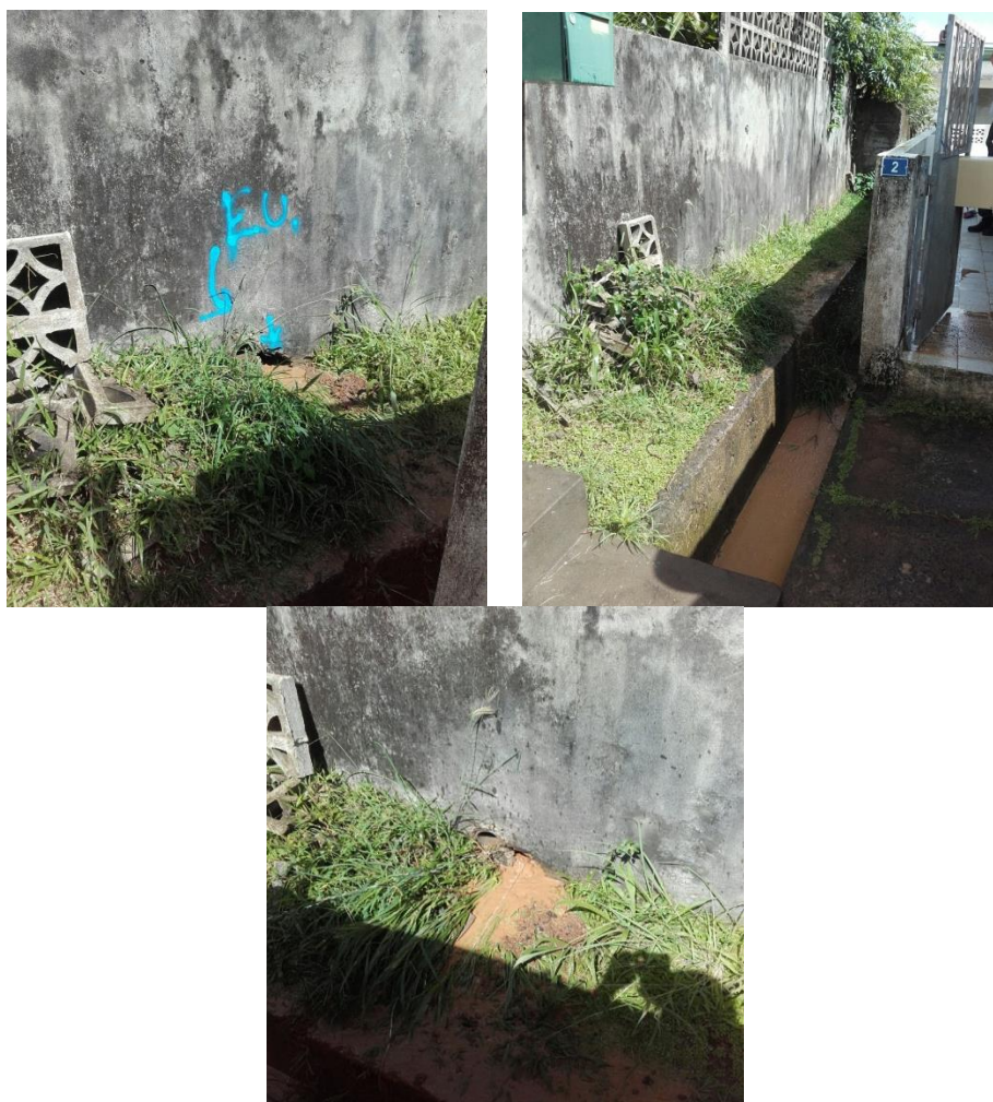
Rejet d'eau dû à la casse : (X, Y) : 14.77535352872692, -60.98958418939156
