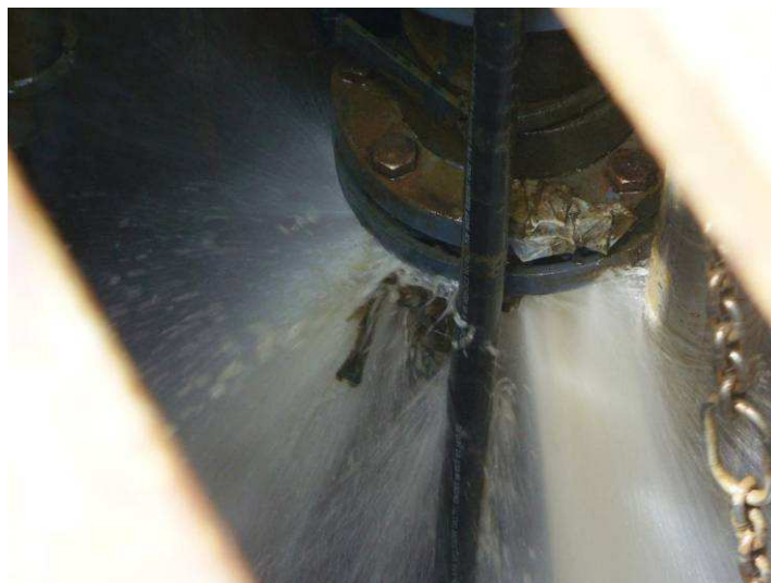
Photo 16 : Fuite sur colonne montante nouveau poste bourg
