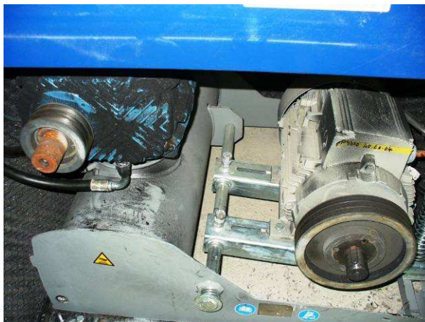
Photo 17 : Rupture des courroies d'un surpresseur
