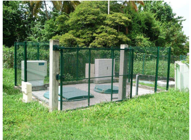
Photo 10 : Nouveau Poste ZI Portuaire
