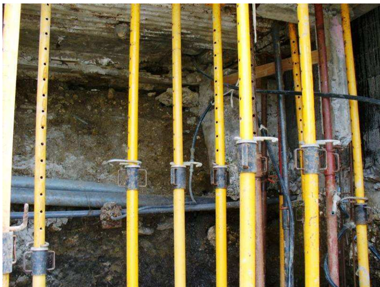
Photo 14 : Extension d'une habitation sur les réseaux
