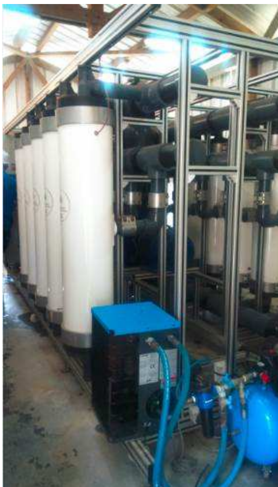
Les modules d'ultra-filtration d'Urion avant leur renouvellement
