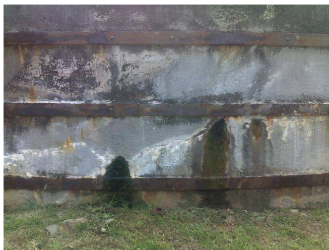
Photo 5: Fissures sur bassin de STEP Fond Henry
