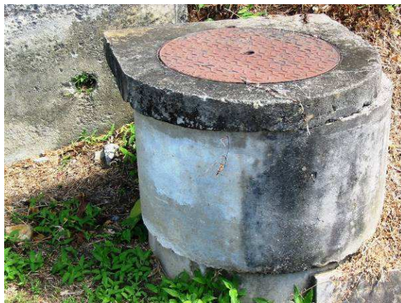
Photo 2 : Exemple de regards non conformes
