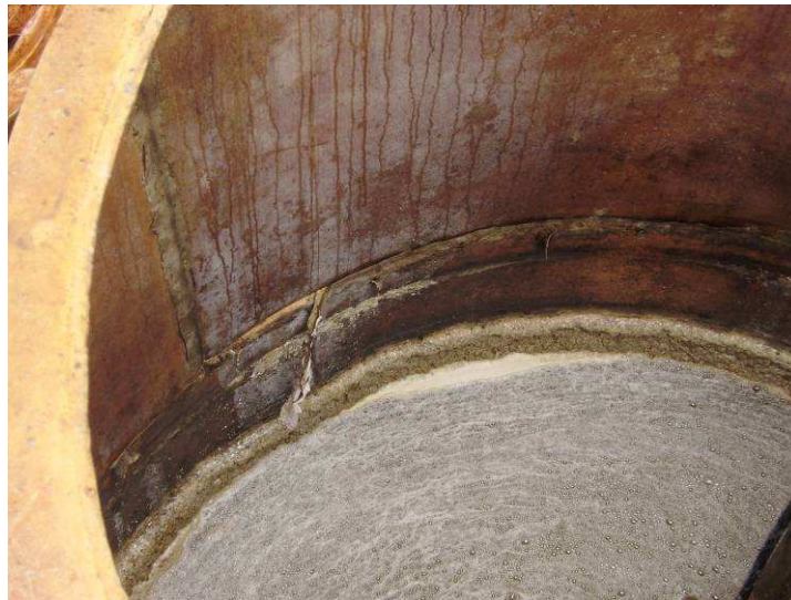
Photo 16 : Dégradation de la bête du PR Les Coteaux
