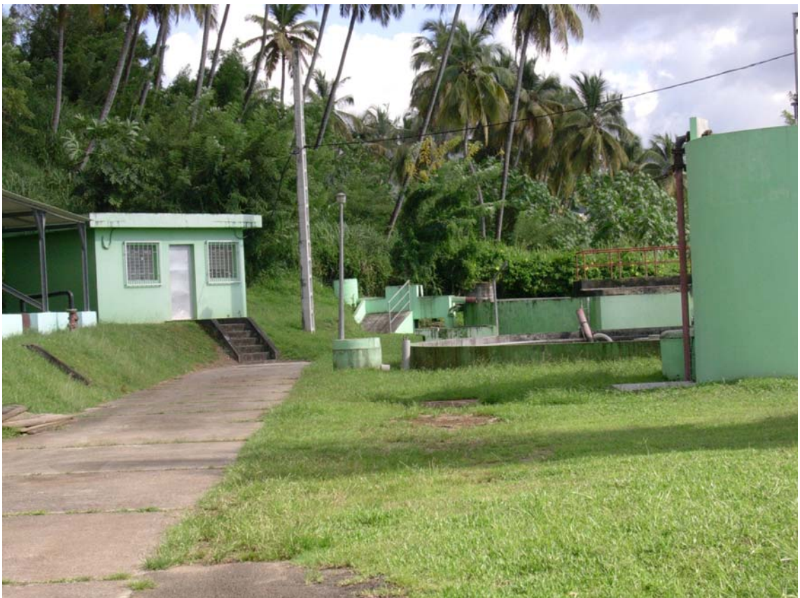
Station de traitement du bourg.
