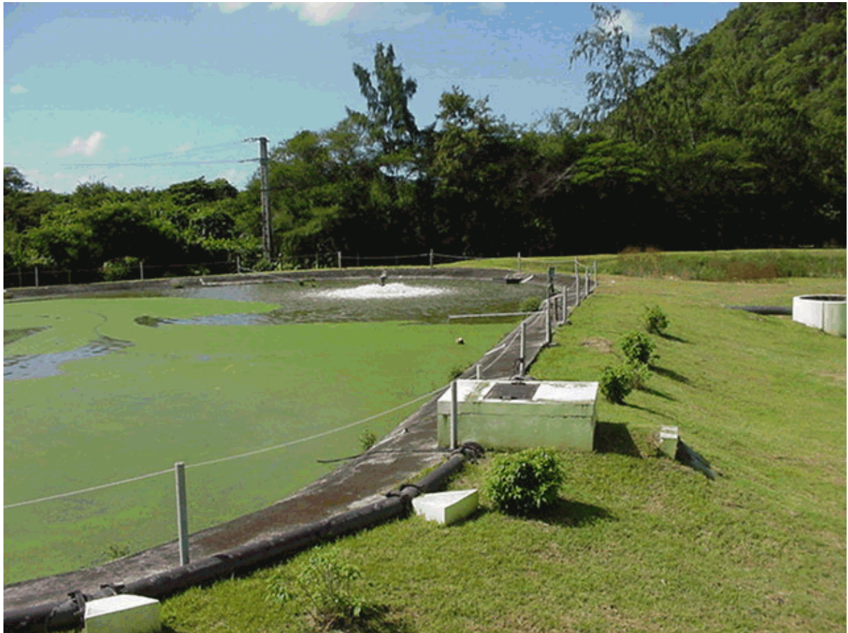
STATION D'EAUX USEES DU BOURG.
