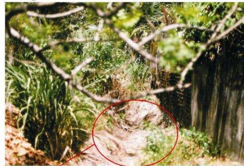
D) Sur la plaine littorale, un mur réduit la capacité de transfert du lit
