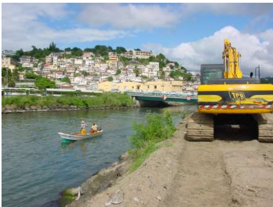
Rivière Madame (canal Levassor) (photo DDE) : curage à l'embouchure au moyen de la pelle à long bras de la DDE (30/11/2004)
