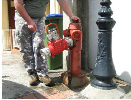
Figure 37 : Manomètre sur poteau incendie
