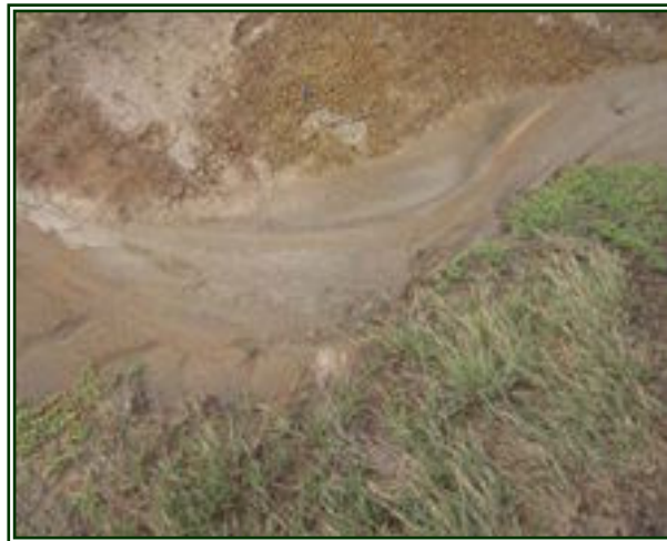
Détail d'une branche du réseau d'érosion. La végétation herbacée ralentit à peine le processus. (Savane de pétrification)
