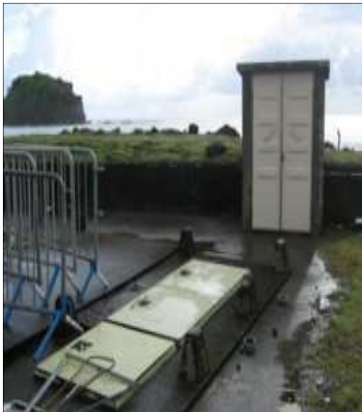
vue d'ensemble: pas de protection
