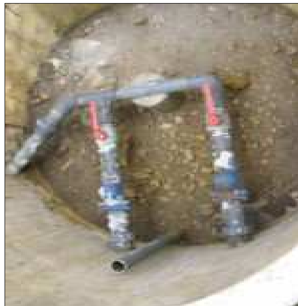
chambre à vannes
