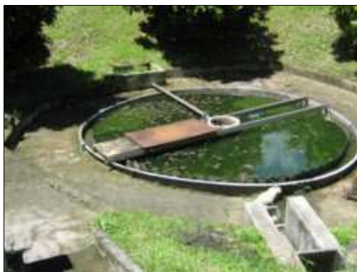
Clarificateur: remontée de boues
