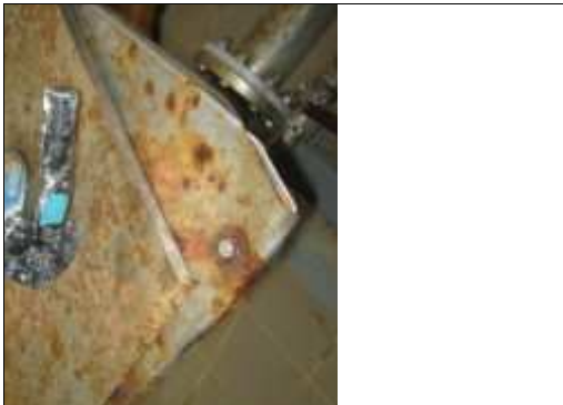
Corrosion des prétraitements
