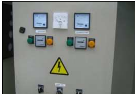
Armoire de commande
