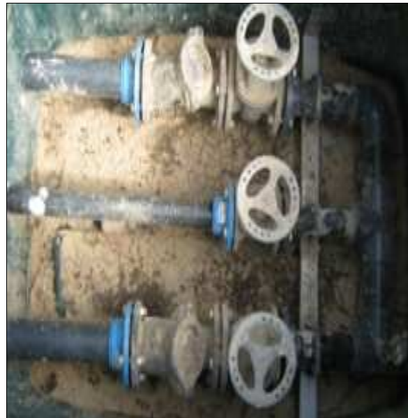
Chambre à vannes
