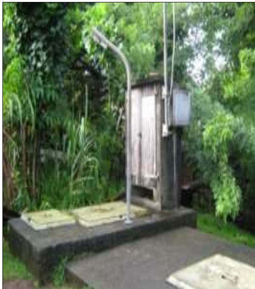
vue d'ensemble: pas de protection
