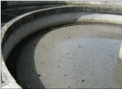
Clarificateur a l'arret
