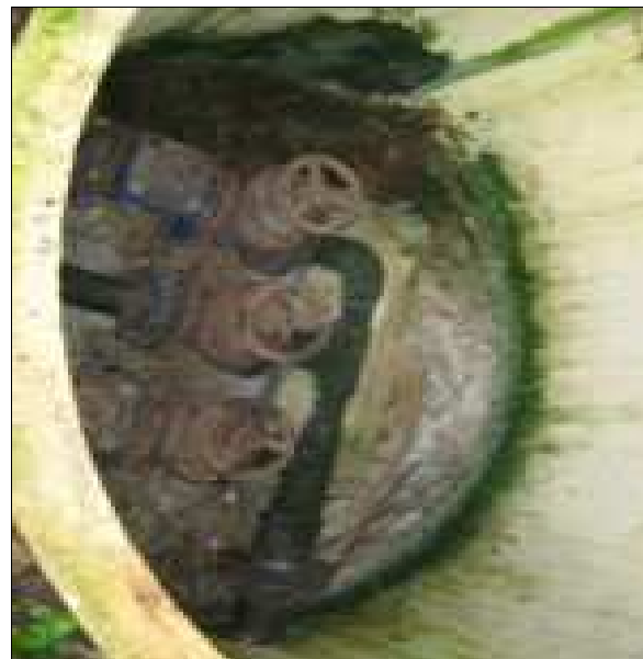
Chambre à vannes: rouille
