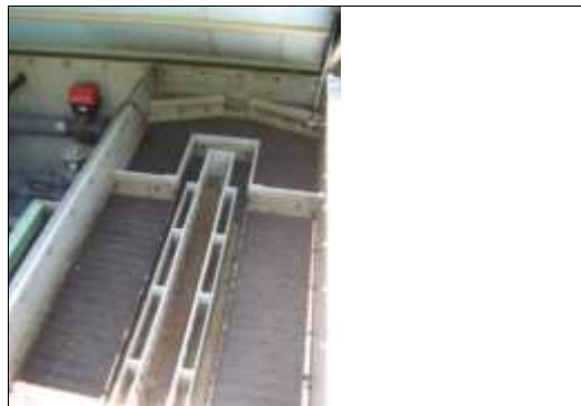
Remontée de boues sur le décanteur lamellaire
