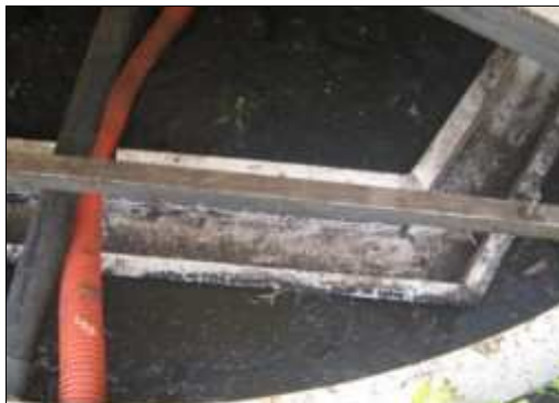
Clarificateur: remontée de boues
