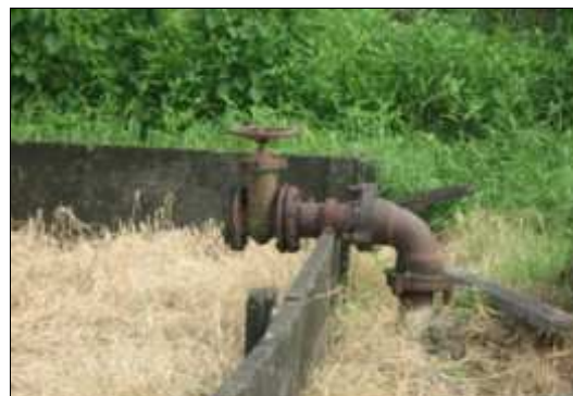
lit de séchage état des vannes
