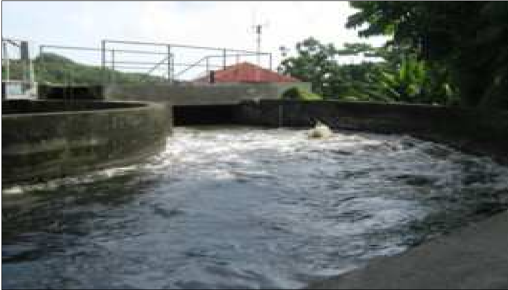
bassin d'aération (hydroéjecteur de secours)
