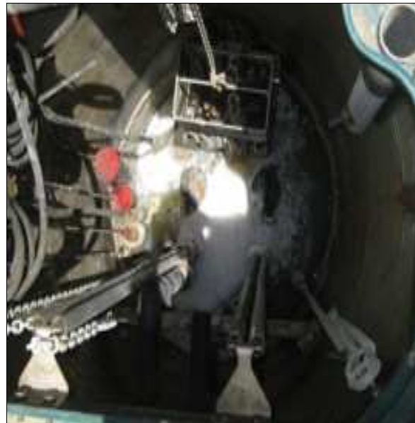
Bache: état correct
