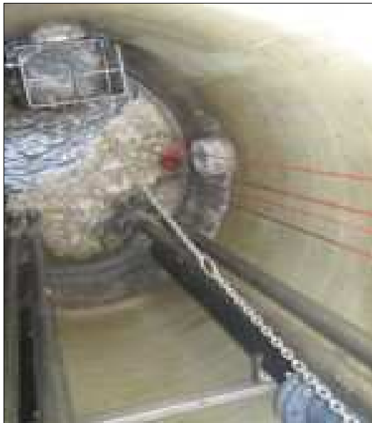
Bache: arrivée des effluents
