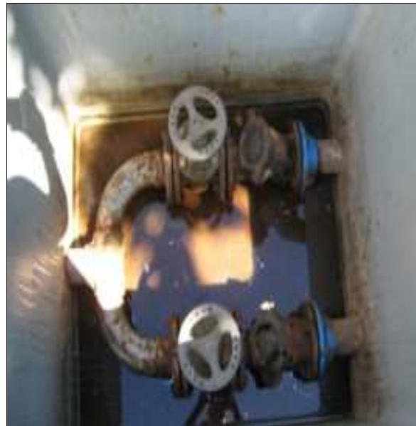
Chambre à vannes: rouille
