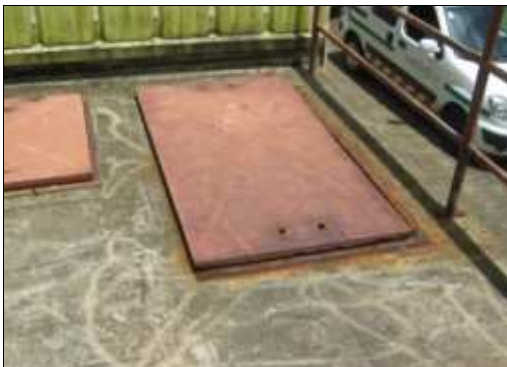
Corrosion trappes prétraitements
