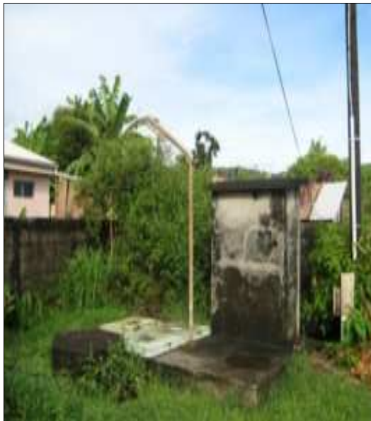
vue d'ensemble: pas de protection
