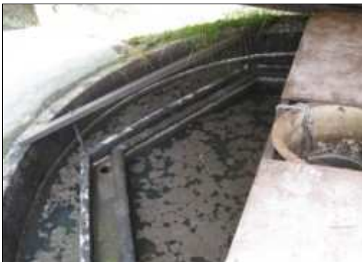
Clarificateur remontée de boues
