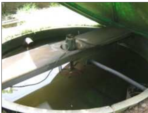
Bassin d'aération lessivé
