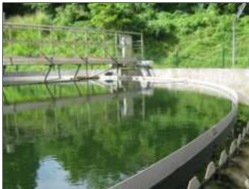
Clarificateur: bon état
