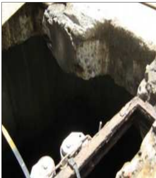
Etat dégradé du GC et des équipements
