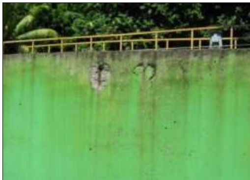
Génie civil abimé
