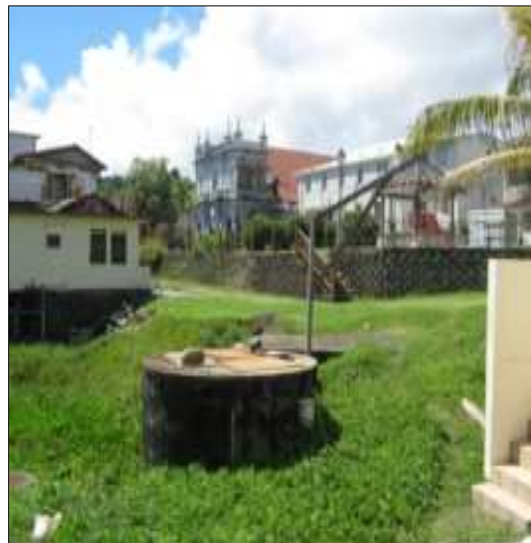
vue d'ensemble: sécurité très limite et rouille des trappes
