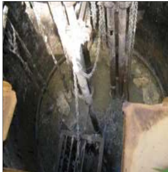
Bache: graisse et mauvais etat equipments
