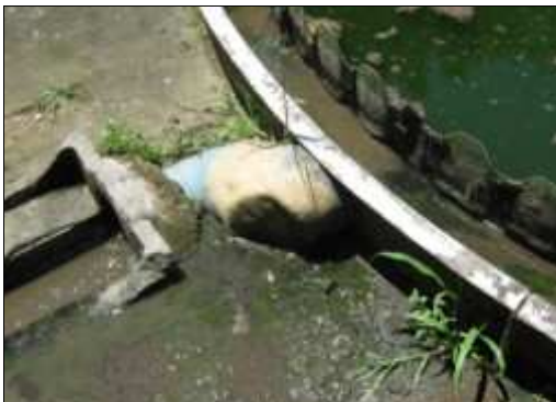
Fuite d'eau sur sortie effluent
