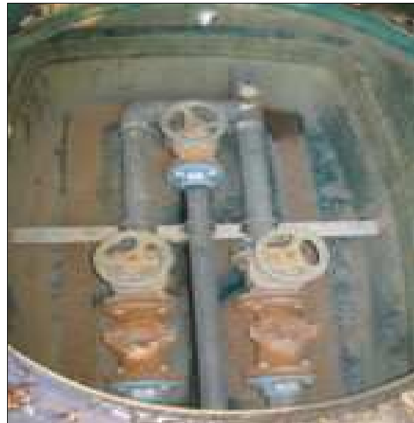
Chambre à vannes: rouille
