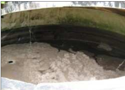
bassin d'aération: mousse
