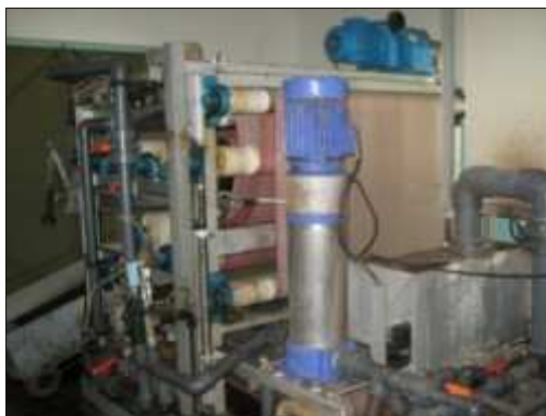
Séchage des boues par filtre à bande
