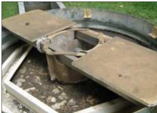
Clarificateur: remontée boues, MES
