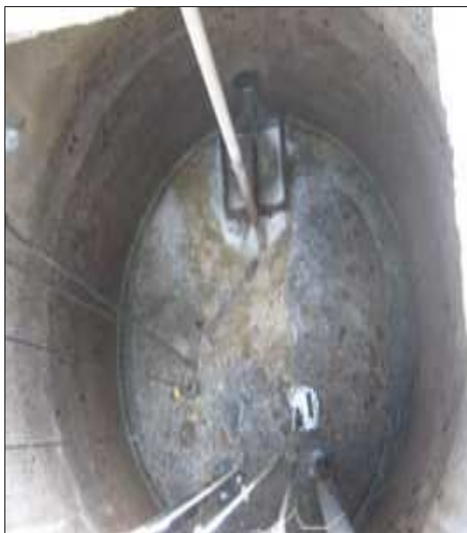
Bache: graisse et absence degrillage
