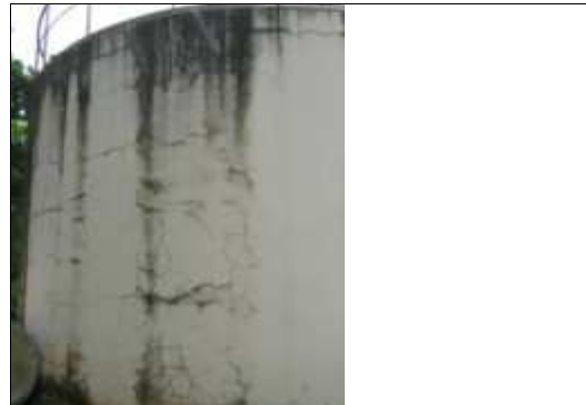
Etat génie civil sur silo à boues
