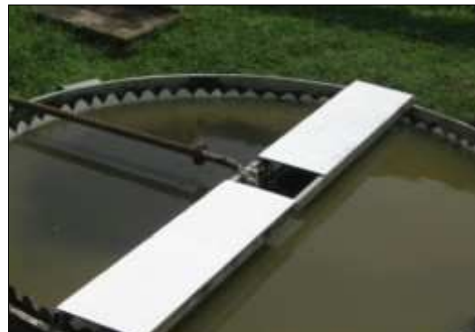
clarificateur file 1: absence de clifford et dispersion de boues
