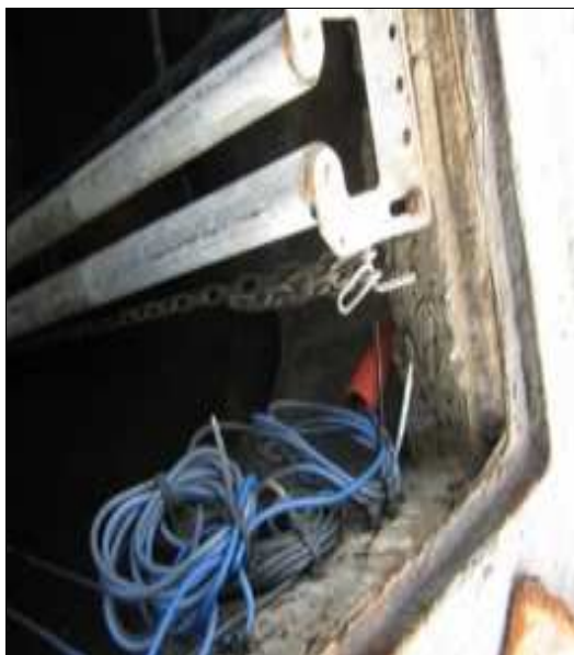
Bache: béton attaqué et rouille des trappes
