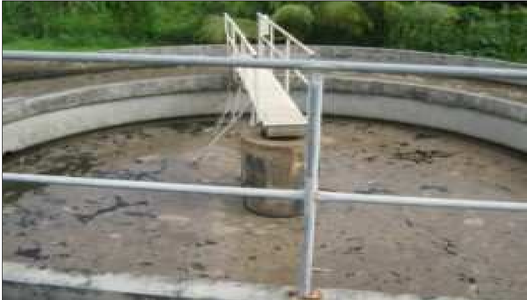
vue sur clarificateur et bassin d'aération
