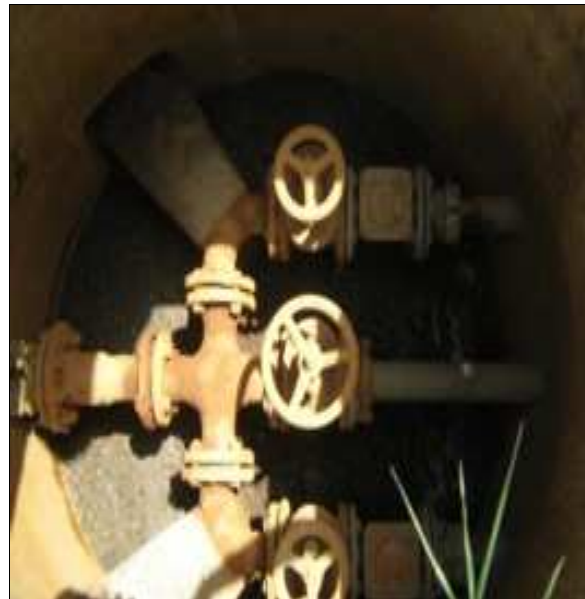
Chambre à vannes: rouille
