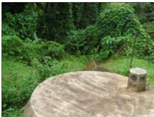
Etat capot clarificateur et cloture
