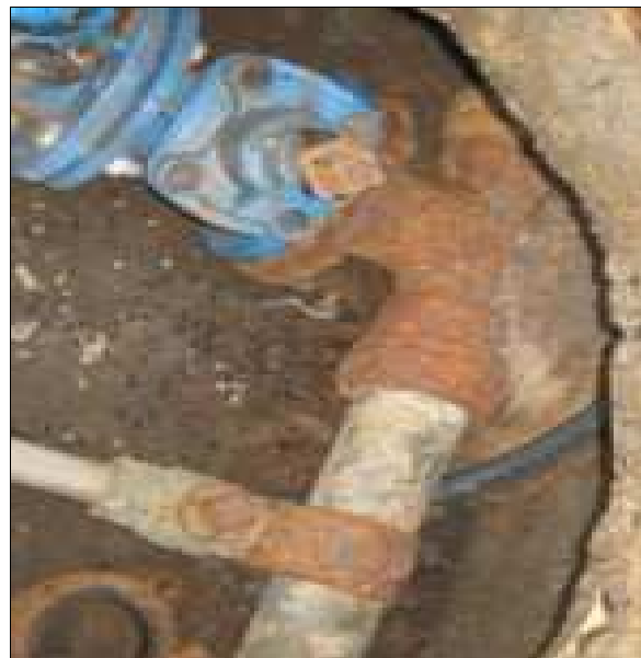
Corrosion des Tés (chambre à vannes)
